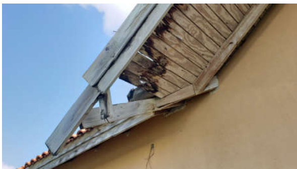
Dak overstekken bij de kilgoot zeer be- schadigd
